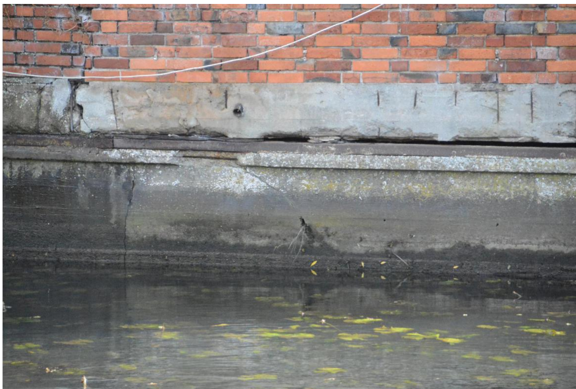
Fotografia nr 3 – Widok świeżych spękań w obrębie ścian fundamentowych.
