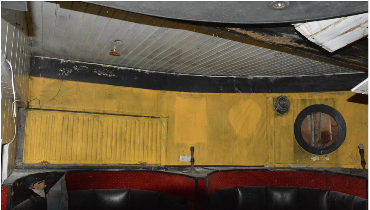
Fotografia nr 9 – Zniszczone meble w pomieszczeniu rotundy. Zniszczenie mebli spowodowane jest zalaniem pomieszczenia rotundy przez wysoką wodę w rzece (tak zwaną cofkę). Zalane meble uległy spaceniu i rozwarstwieniu. Na rozwarstwionych drewnianych meblach rozwinęły się grzyby.
