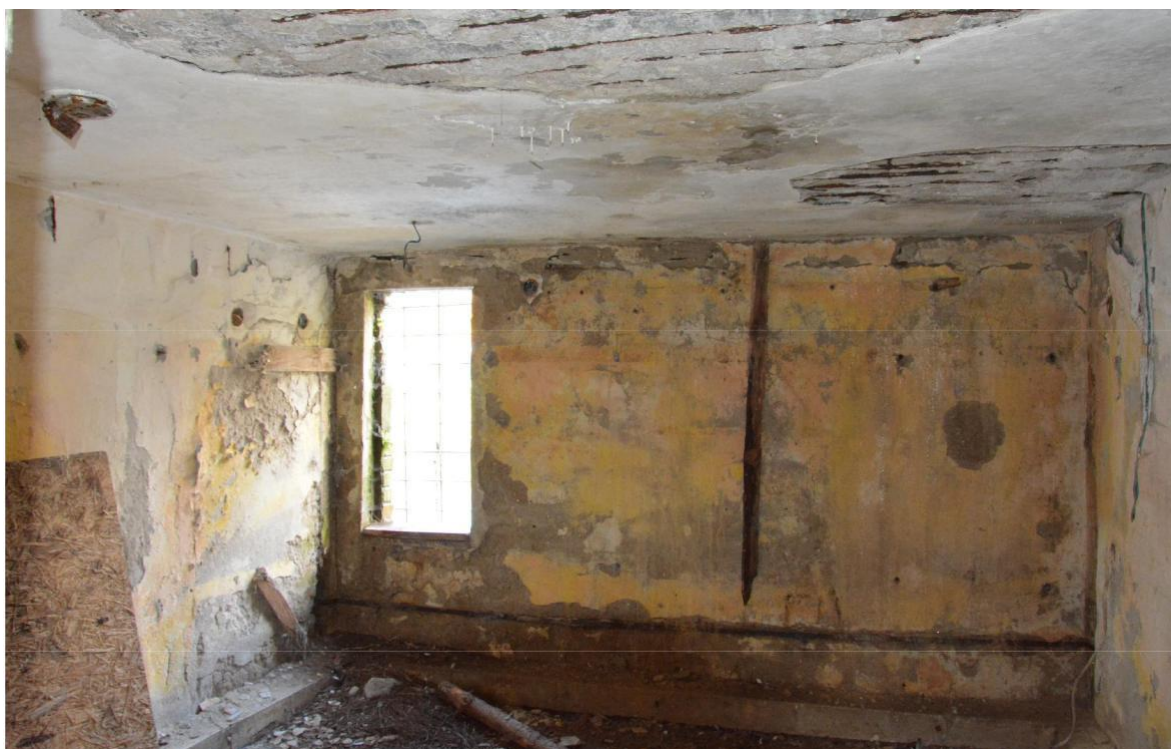
Fotografia nr 8 – Zbliżenie pomieszczeń piwnic. Zagrzybienie piwnic w pobliżu rotundy jest następstwem wysokiego poziomu wody w rzece Tuga (tak zwana cofka).
