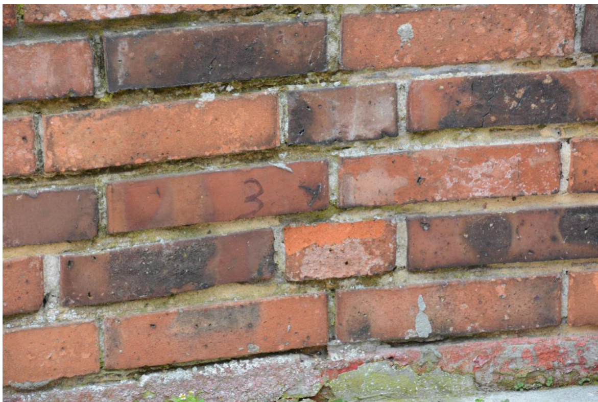
Fotografia nr 17 – Miejsce pobrania próbki nr 3 do badań laboratoryjnych na obecność soli budowlanych.
