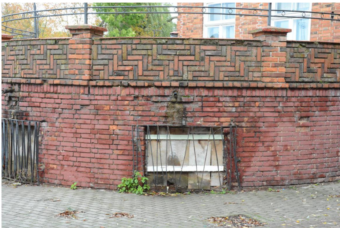
Fotografia nr 6 – Spękania na murze rotundy od strony południowej .
