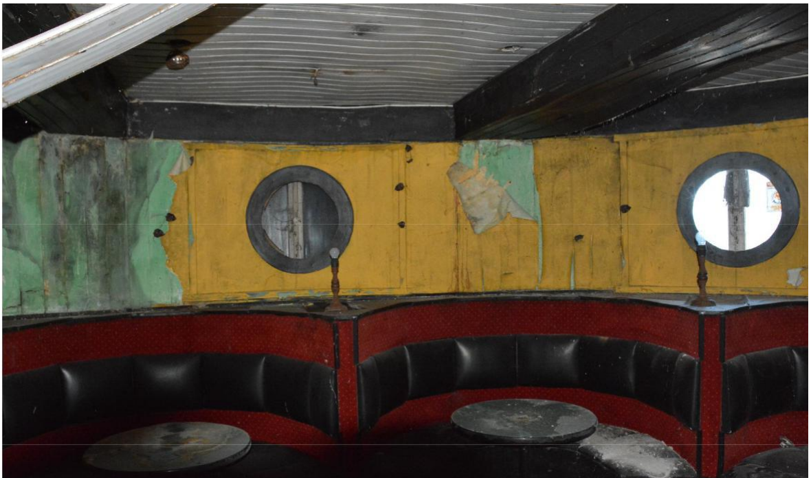
Fotografia nr 10 – Zniszczone meble w pomieszczeniu rotundy. Zniszczenie mebli spowodowane jest zalaniem pomieszczenia rotundy przez wysoką wodę w rzece (tak zwaną cofkę). Zalane meble uległy spaceniu i rozwarstwieniu. Na rozwarstwionych drewnianych meblach rozwinęły się grzyby.
