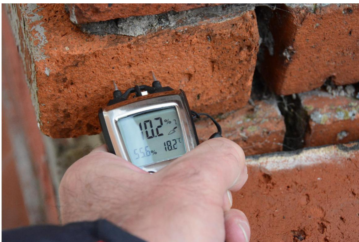
Fotografia nr 14 – Pomiar wilgotności muru w miejscu pobrania próbki nr 1 do badań laboratoryjnych na obecność soli budowlanych. W = 10,2\% .
