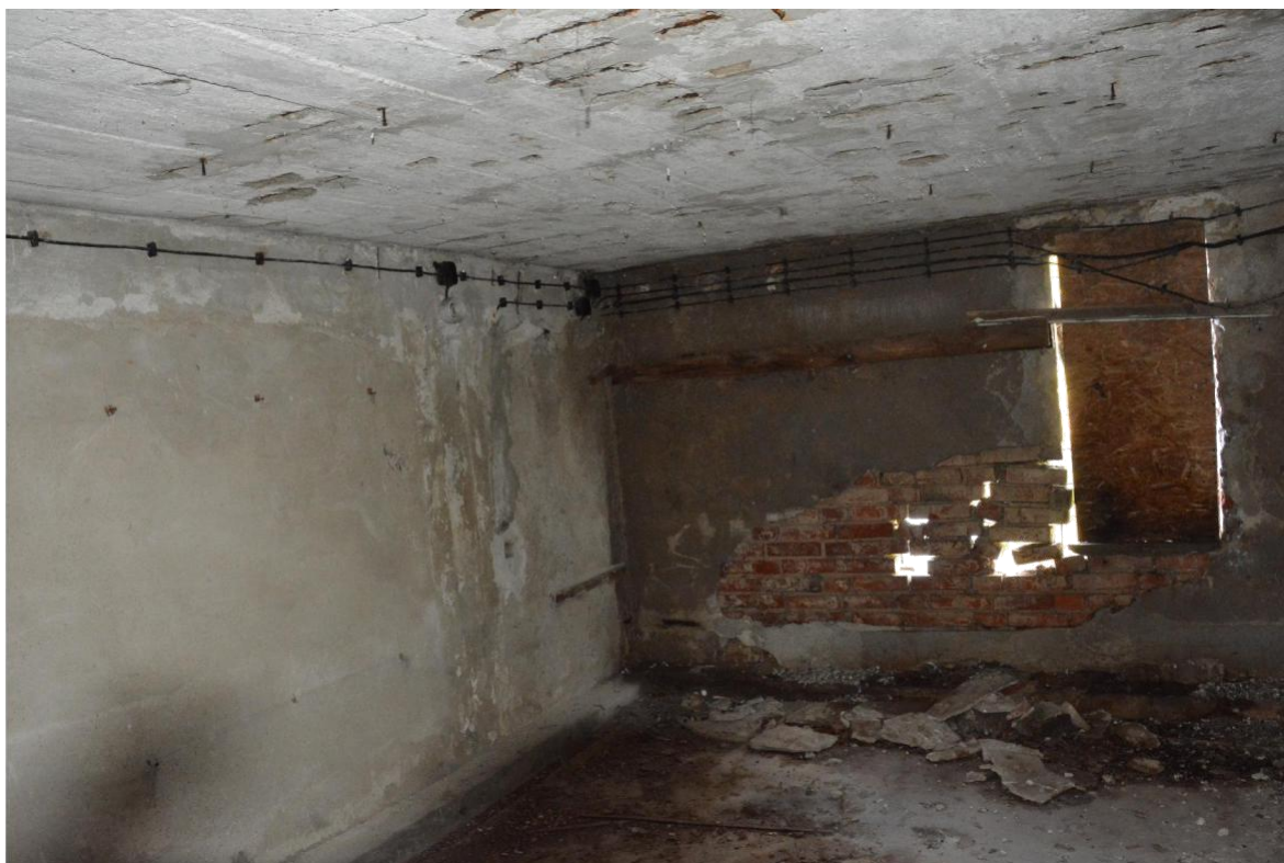
Fotografia nr 7 – Zbliżenie pomieszczeń piwnic. Zagrzybienie piwnic przyległych do rotundy jest następstwem wysokiego poziomu wody w rzece (tak zwana cofka).
