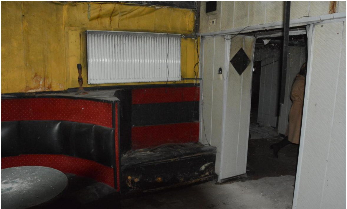
Fotografia nr 11 – Zniszczone meble w pomieszczeniu rotundy. Zniszczenie mebli spowodowane jest zalaniem pomieszczenia rotundy przez wysoką wodę w rzece (tak zwaną cofkę). Zalane meble uległy spaczeniu i rozwarstwieniu. Na rozwarstwionych drewnianych meblach rozwinęły się grzyby.
