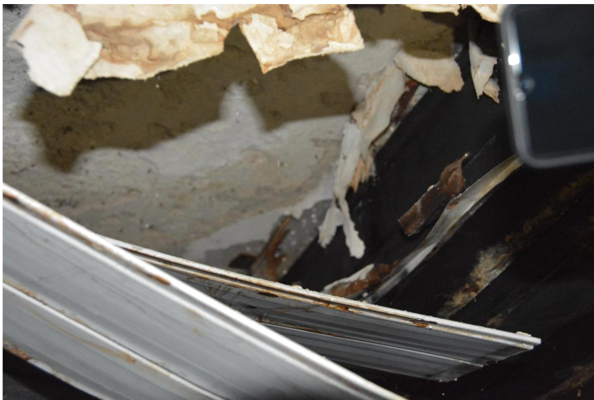
Fotografia nr 13 – Pęknięcie w stropie nad rotundą, widok od środka.
